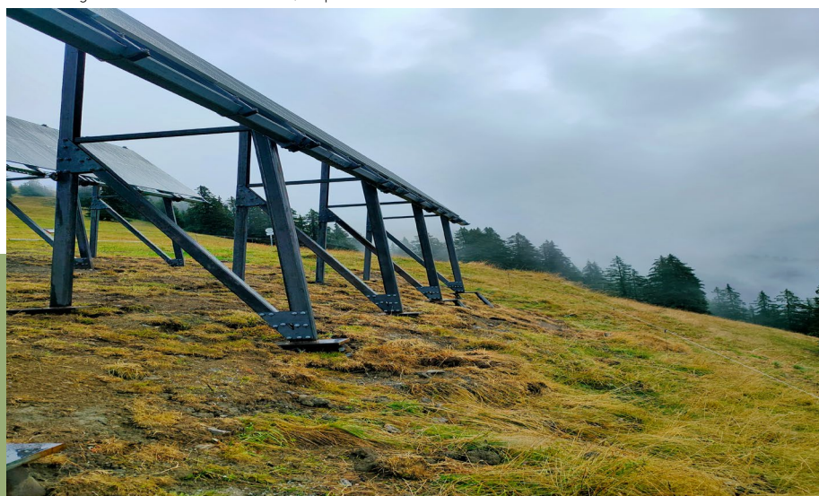
Installation pilote Solsarine sur le Hornberg, Impact Gstaad AG (photo: Thomas Mathis).
